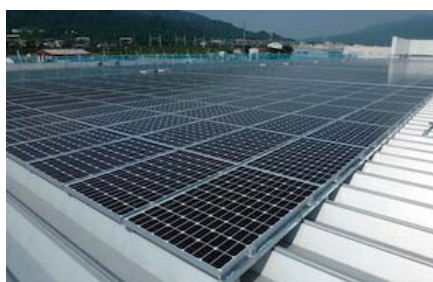
垂井工場の太陽光発電パネル
